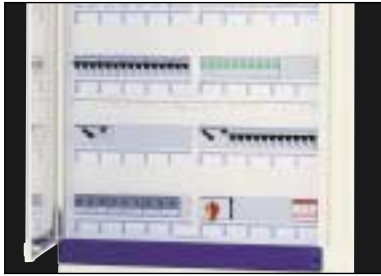
Einbaugruppen im Energieverteiler für Reihen-einbaugeräte
