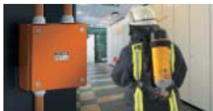
Kabelabzweigkästen mit Funktionserhalt vor Ort
