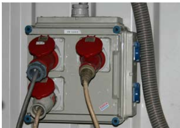
Beispiel: Seitlicher Anbau von Steckdosen Bedienung schlecht zugänglich.
