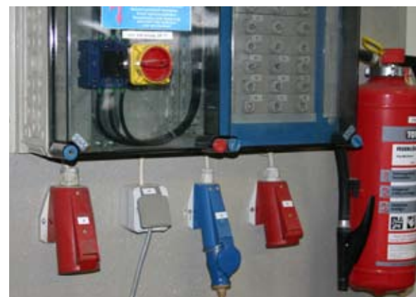
Beispiel: Energieverteiler mit einzeln installierten Steckdosen Hoher Installationsaufwand und schlechte Optik.
