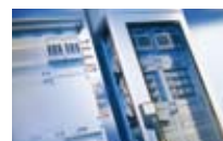
MC-Verteiler bis 630 A, IP 55
