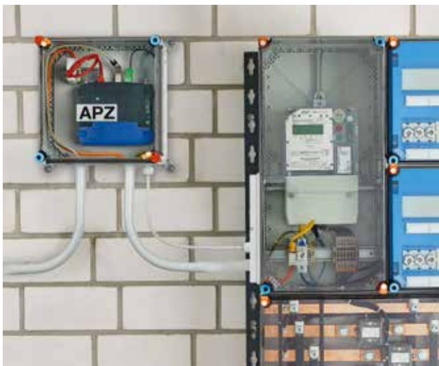
APZ-Gehäuse neben der Energieverteilung mit Zählerplatz
