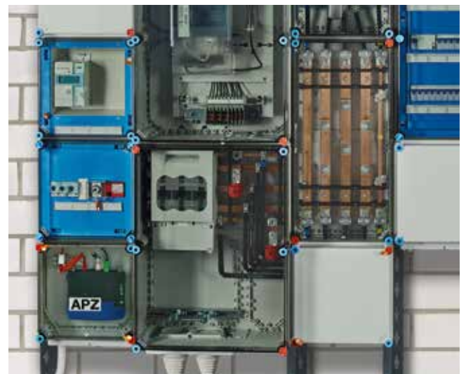
APZ integriert unten in der Energieverteiler mit Zählerplatz
