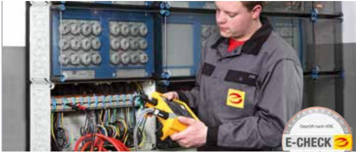
Durchführen der Isolationswiderstandsmessung bei Inbetriebnahme und wiederkehrenden Prüfungen. Die Isolationswiderstandsmessung ist auch fester Bestandteil des E-CHECK.
