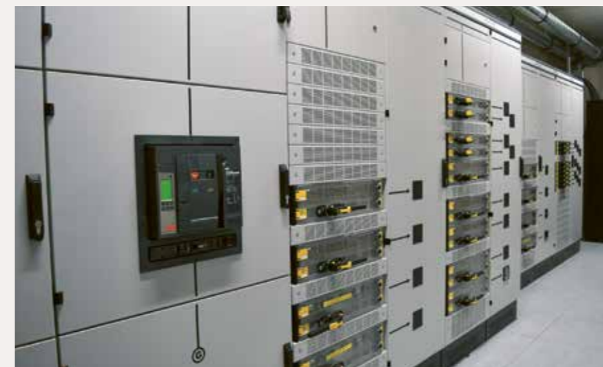
Diese Niederspannungs-Schaltanlage mit aktivem Störlichtbogenschutzsystem ist bei einem Energieversorger im Einsatz
