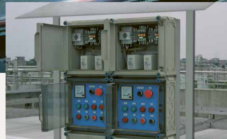
Wasseraufbereitungs- und Abwasseranlagen in China
