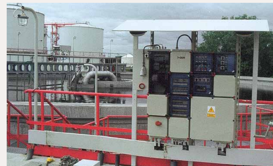
Wasseraufbereitungs- und Abwasseranlage in Danzig, Polen
