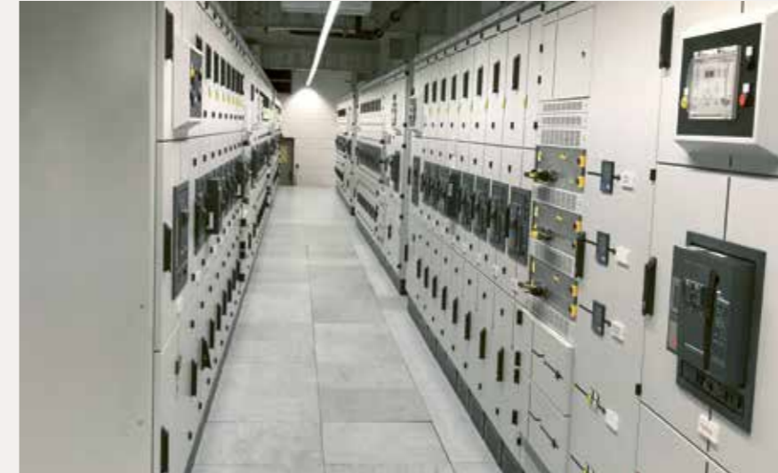
Bei einem Automobilhersteller ist ein aktives Störlichtbogensystem im Einsatz.
