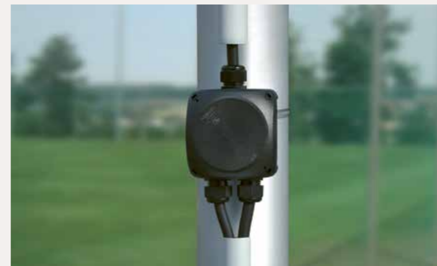
Auf einem Sportplatz wurde der Kabelabzweigkasten Serie KF an einem Mast befestigt.
