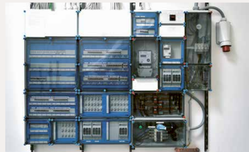
Die Mi-Schaltanlage sorgt für die sichere Energieversorgung in einem Attendorfer Feuerwehrhaus.
