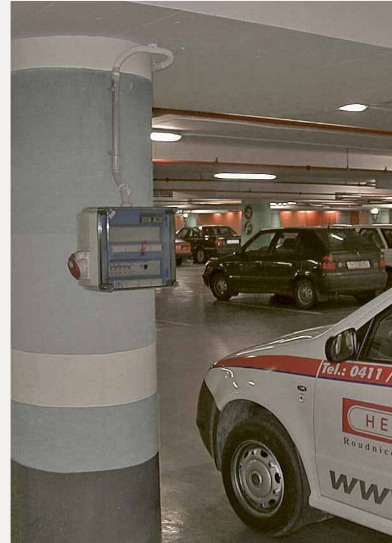
Mi-Verteiler in einem Einkaufszentrum in Tschechien
