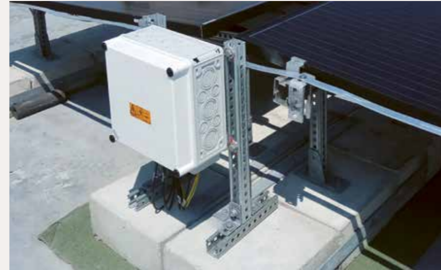
Zahlreiche PV-Generator-Anschlusskästen sind auf dem Dach eines Hotels installiert.
