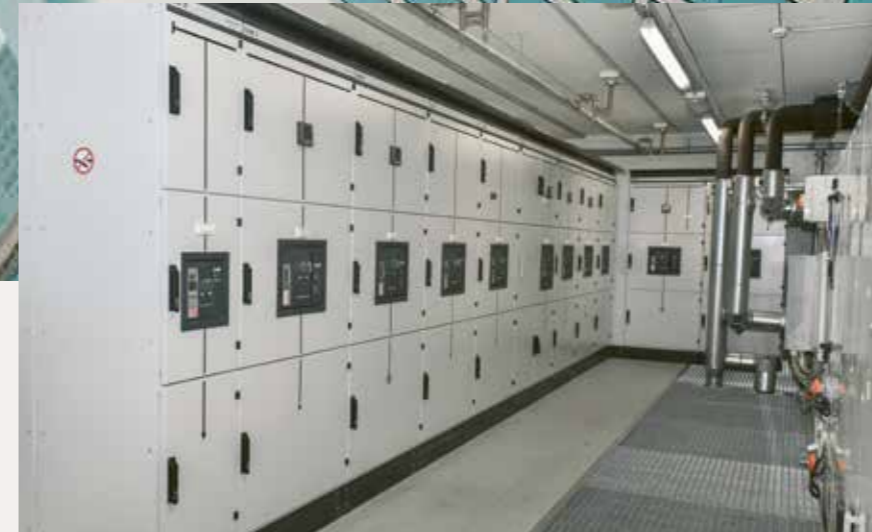
In einem Düsseldorfer Bürogebäude sind neun Niederspannungs-Schaltanlagen in Betrieb.
