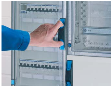
■ Deuren met handbediening voor toegang van apparatuur door leken
