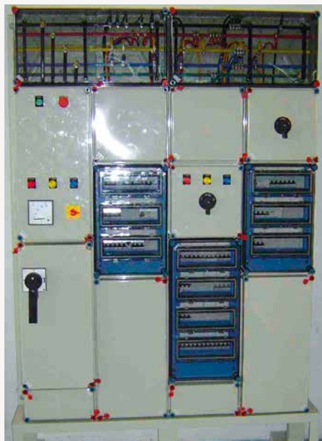
Rozdzielnica główna na stacji benzynowej
