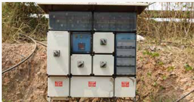
Rozdzielnica zainstalowana w elektrowni wodnej.
