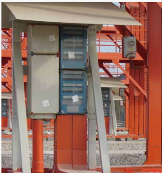
Wysokowydajna rozdzielnica oświetleniowa na placu kontenerowym
