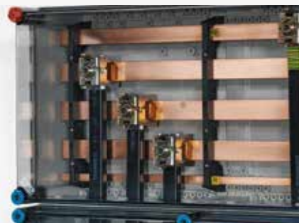
Na przykład szyny zbiorcze zamocowane na wspornikach wykonanych z izolowanego materiału.
