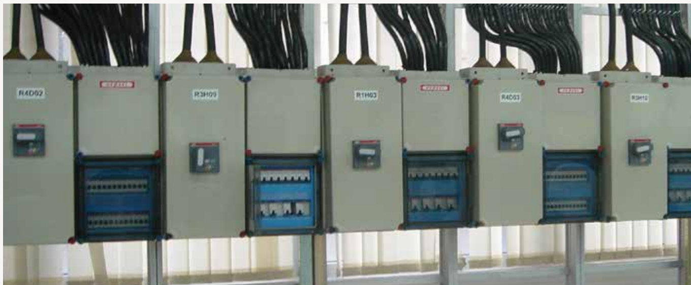
Rozdzielnice sterowania oświetleniem w fabryce telefonów komórkowych
