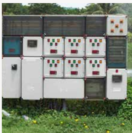
+ Zewnętrzna rozdzielnica elektryczna zainstalowana na trawniku luksusowego hotelu.
