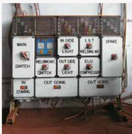
+ Rozdzielnica elektryczna zainstalowana w warsztacie konserwacyjnym kopalni rudy żelaza
