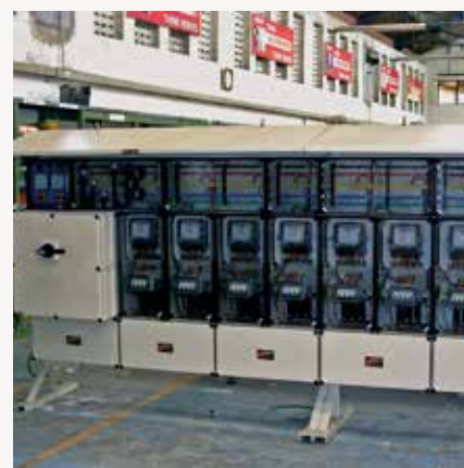
+ Panel pomiarowy z licznikami KWH w firmie dostarczającej energię elektryczną
