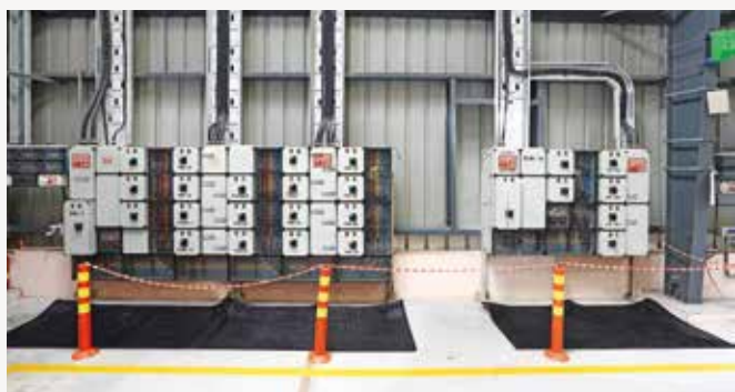
Rozdzielnice zasilania zainstalowane w przemyśle lekkim
