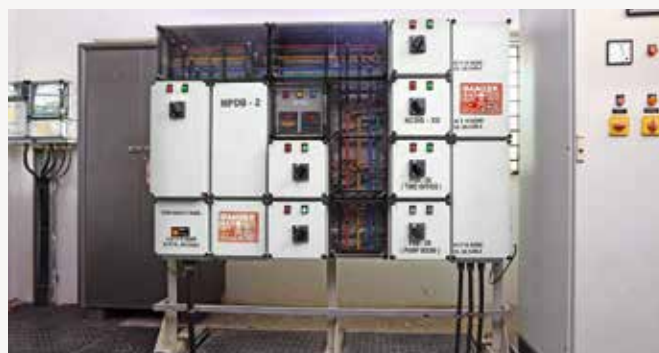
Rozdzielnica główna zainstalowana w odlewni.
