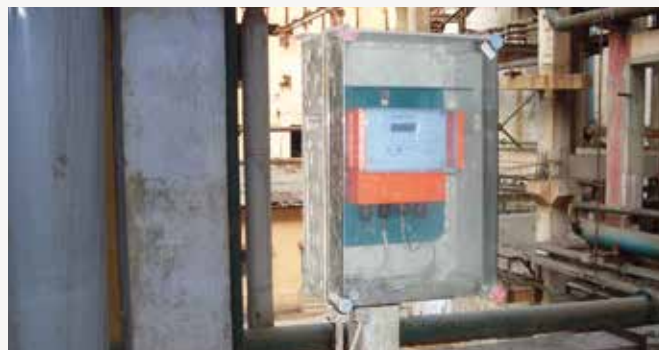
Obudowa przyrządu w stacji pomp
