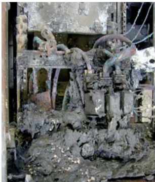
Nach einem Störlichtbogen ohne Störlichtbogenschutz.
