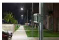
Beleuchtungssteuerung einer Wohnanlage mit Parkplatz
