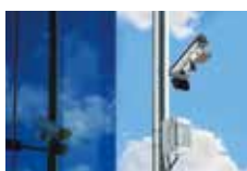
Energieversorgung einer Überwachungskamera im öffentlichen Raum
